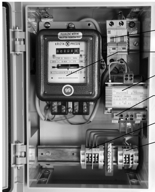
Obr. 1 - 12 Vnitřek skříně zdroje ZDR03
