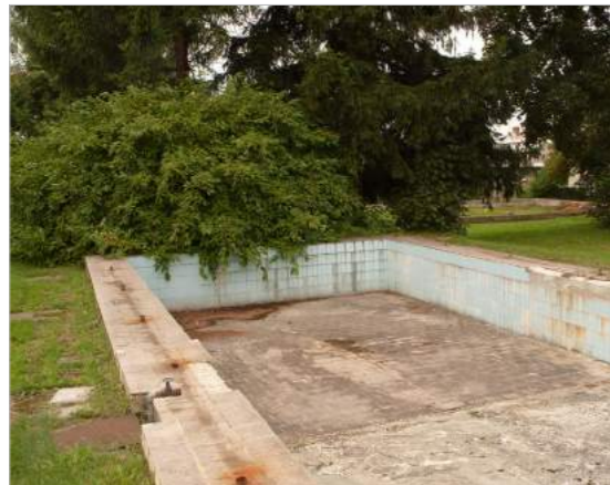
44. nepoužívaný zchátralý betonový bazén, pohled z centrální plochy
