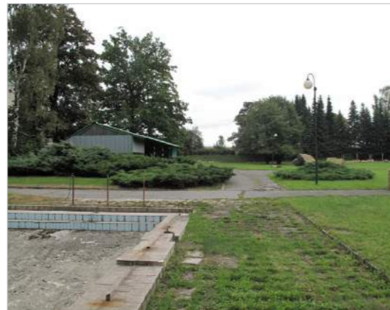
45. nepoužívaný zchátralý betonový bazén, pohled od východu, v pozadí plechový parkovací přístřešek
