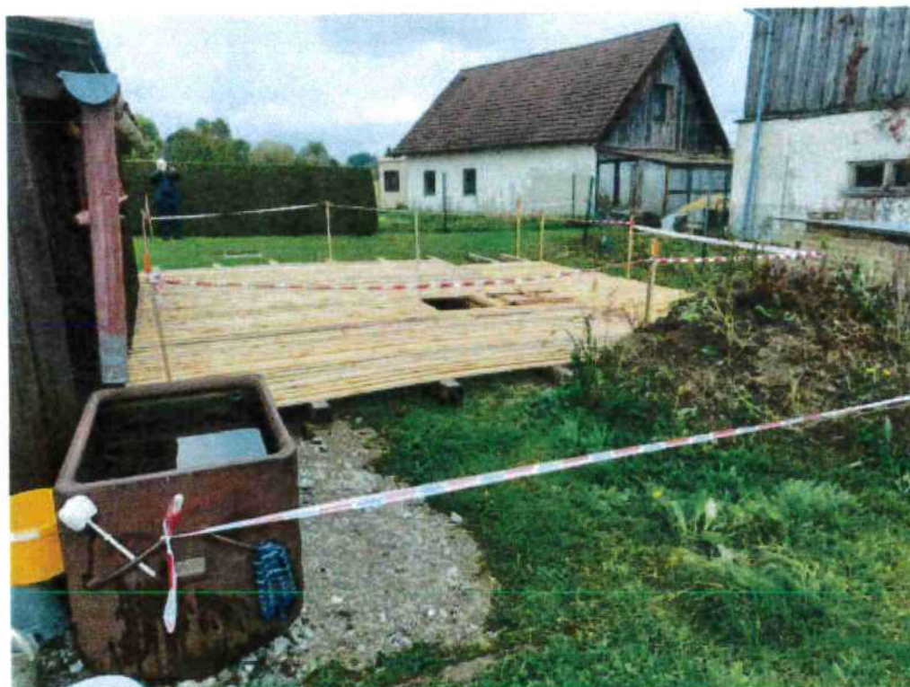
Obr. 5: Provizorní zakrytí propadu, pohled od JZ
