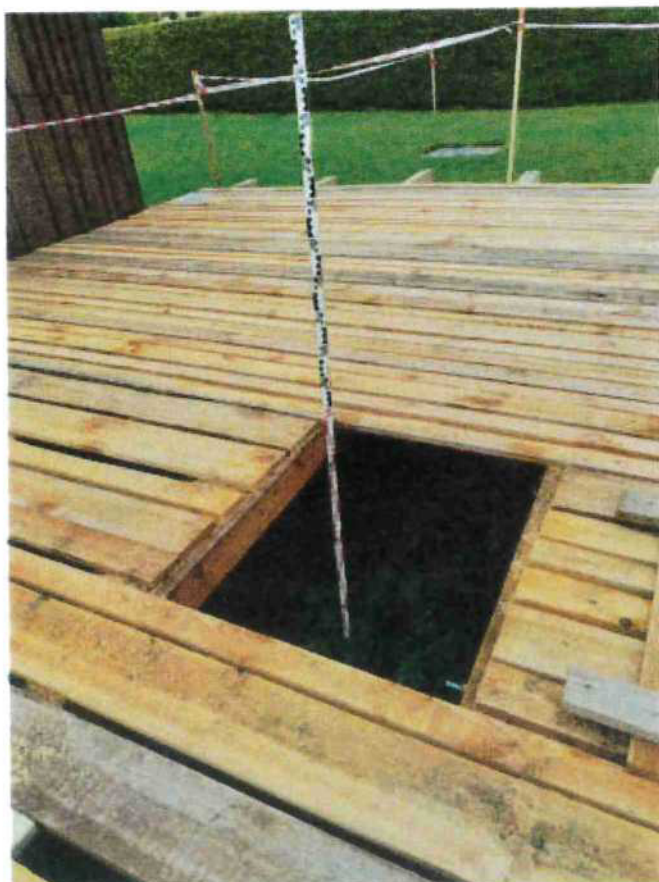
Obr. 6: Detailní pohled do propadu z provizorního povalu
