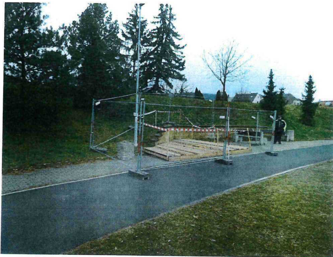
Foto č. 3: Celkový pohled na provizorní zajištění propadu, stav 24. 3. 2025 (Foto: RNDr. Pavel Šír)
