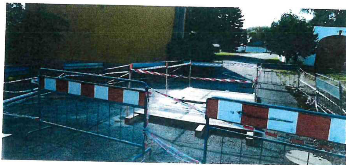
Pohled na zajištěný propad (poval 2,5 x 4 metry)
