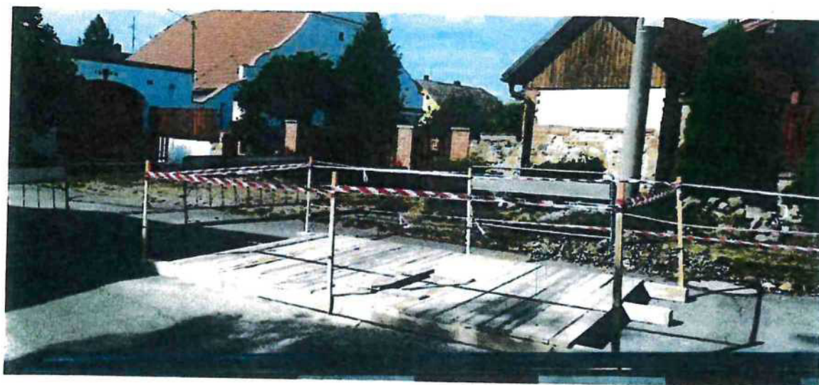
Pohled na zajištěný propad (poval 2,5 x 4 metry)
